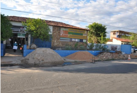
Imagem 43 – CSU antes da Reforma
