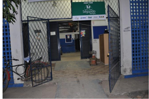
Imagem 44 – CSU antes da Reforma
