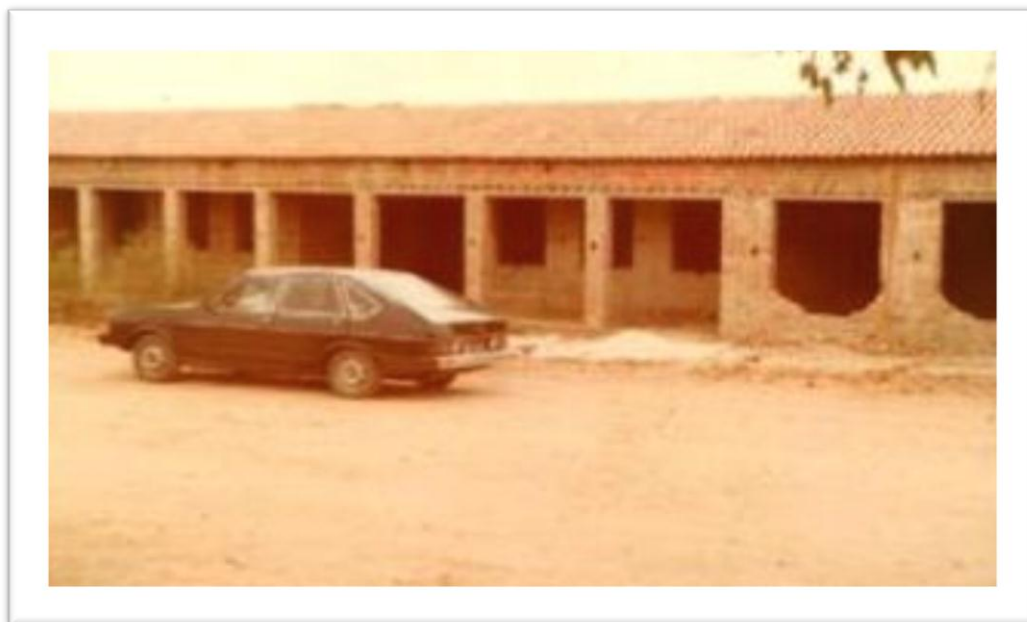
Figura 07: Início da construção da sede própria da Unidade Escolar “Cenecista” Padre Cícero Romão Batista, 1980.
